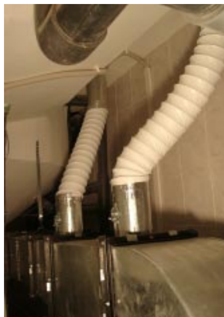
Приточный воздуховод в подбассейновом пространстве
