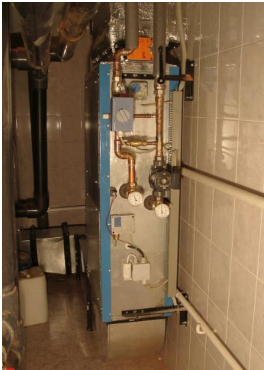
Приточная установка смонтирована вертикально в подбассейновом пространстве
