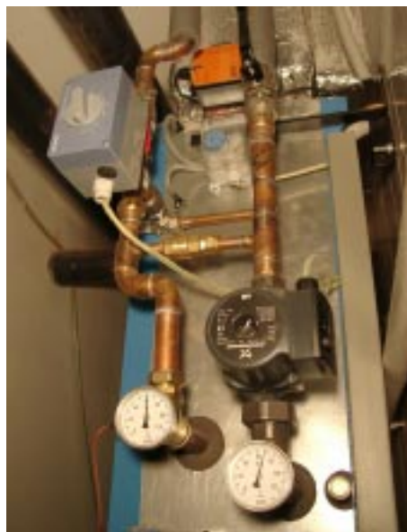
Узел регулирования приточной установки
