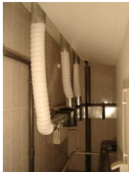
Воздуховоды, подводящие очищенный теплый воздух к напольным решеткам, снабжены дроссель-клапанами для регулирования воздушных потоков
